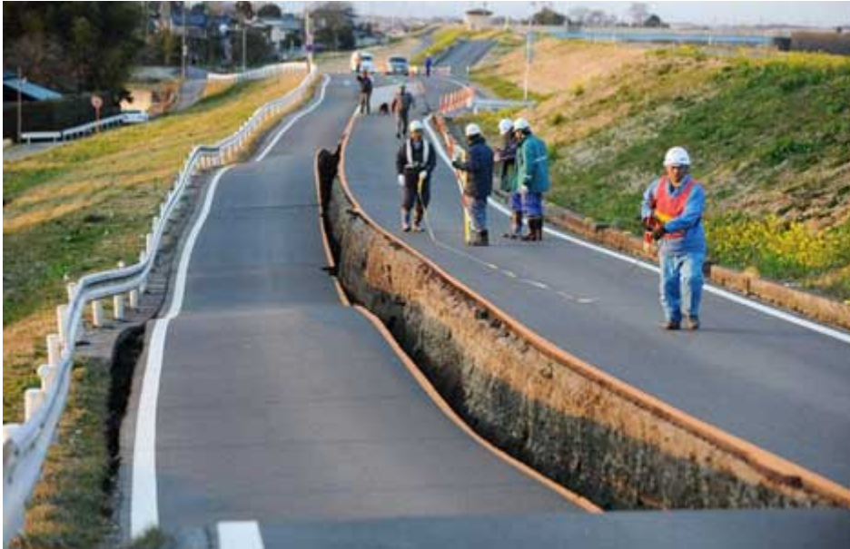
Carretera en Saitama afectada por la licuefacción el pasado 11 de marzo.
